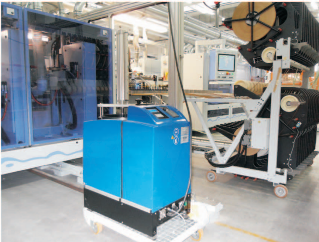
Das Gerät wird auf einem Wagen montiert und bewegt sich entsprechend der Breitenverstellung der Kantenleimmaschine.
